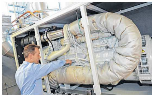
Jörg Tuxhorn hat das Blockheizkraftwerk entwickelt und überprüft gerade die Anlage, die seit Juni störungsfrei in Betrieb ist.
