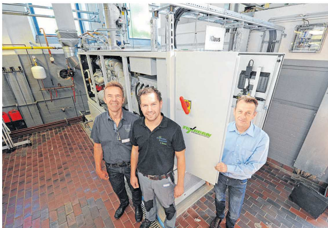
Das sind die Fachleute fürs neue Blockheizkraftwerk im Kesselhaus des Willibrord-Spitals in Emmerich (v.l.): Klaus Meyer, Leiter Haus- und Betriebstechnik, Daniel Beenen, stellvertretender Werkstatteleiter, und der Konstrukteur der Anlage, Jörg Tuxhorn vom gleichnamigen Unternehmen aus Borken.
