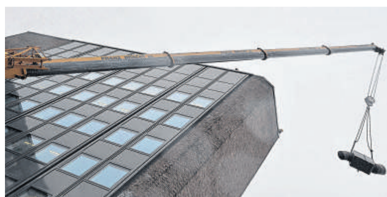
Sieht klein aus - wiegt aber 3,9 Tonnen: ein alter Heizkessel.
