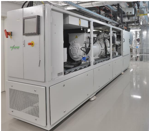
Bild 4.17: Heizungszentrale mit Kraft-Wärme-Kopplung im neuen Erweiterungsbau des Fraunhofer IISB, (Bild: Kurt Fuchs / Fraunhofer IISB)
